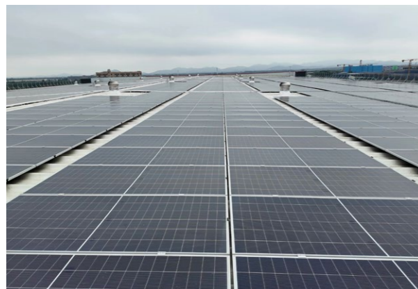
2025年8月，深国际冷链南京·江宁项目光伏项目正式启用，首月发电量达20.39万千瓦时
