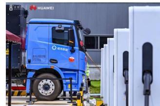
深国际坪山项目重卡超充站
