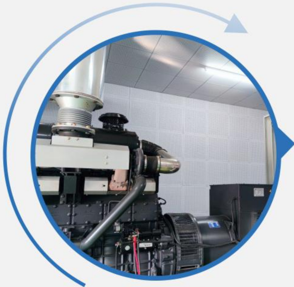
发电机房吸音板
